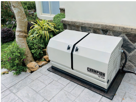
雲端機房 (北部)
